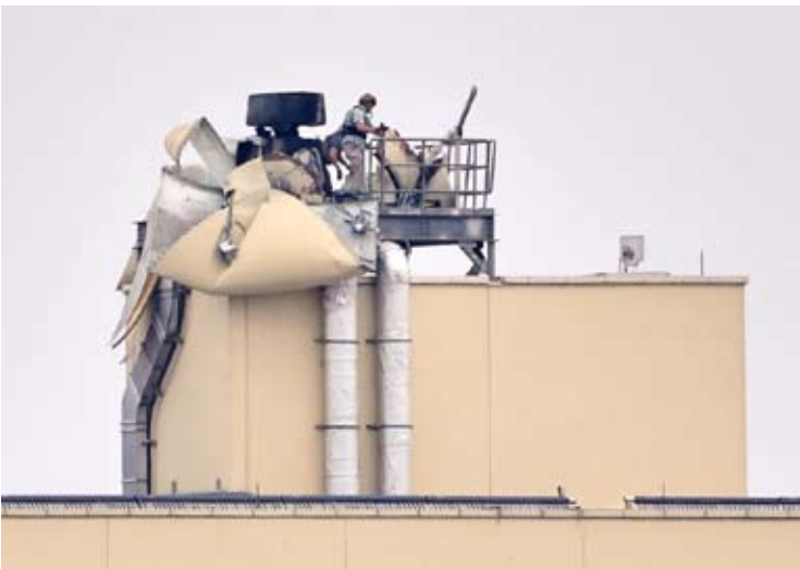
2026年3月14日，美国驻伊拉克大使馆人员在巴格达查看爆炸造成的设施损毁情况。（美联社）
