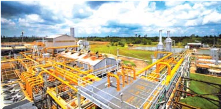
图为位于印尼东加里曼丹省库卡塔内加拉县穆阿拉巴达克的Pertamina Hulu Sangasanga (PHSS)公司油气处理设施。
