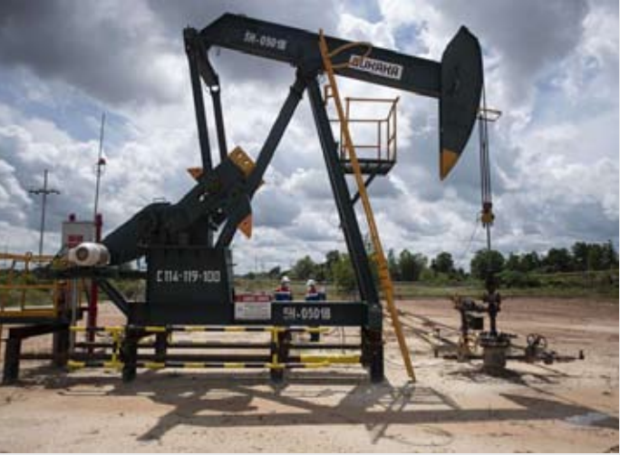
图为PT Pertamina Hulu Rokan公司（PHR）员工在廖内省望加丽县罗坎区块杜里油田中央集输站（CGS-10）检查抽油机设备。
